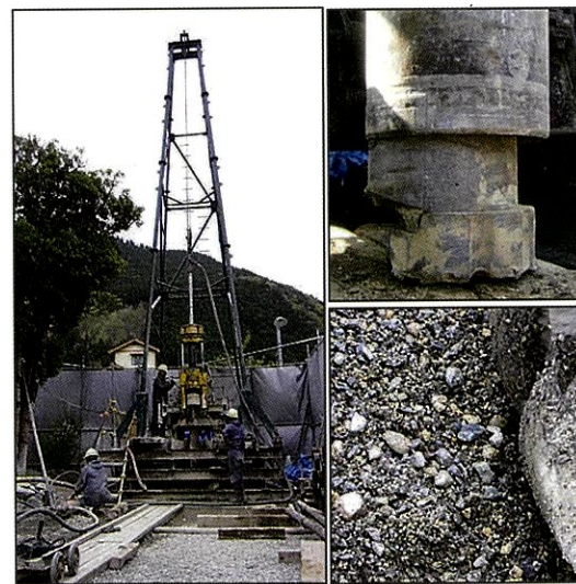
写真-2 水井戸掘削現場の状況（左） 二重管ビット（右上） 川砂利のようなスライム（右下）
